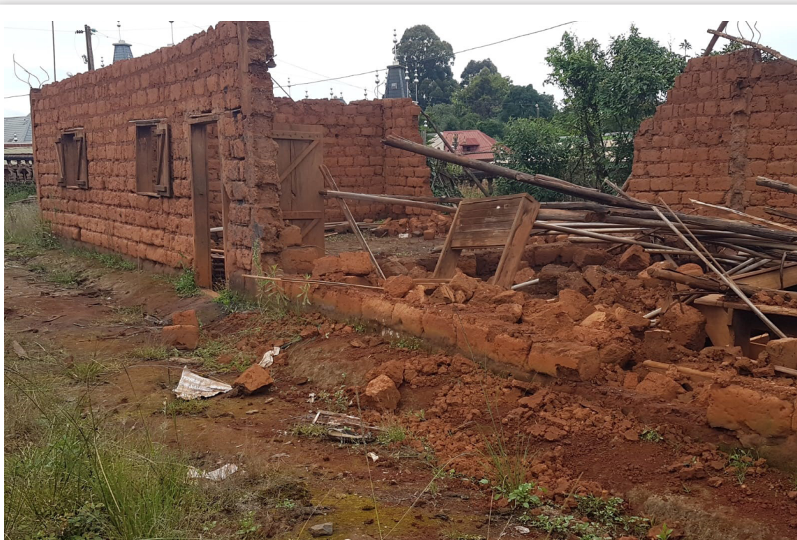
Image de l'école après l'effondrement : des dizaines d'enfants sont abandonnés à eux-mêmes.
